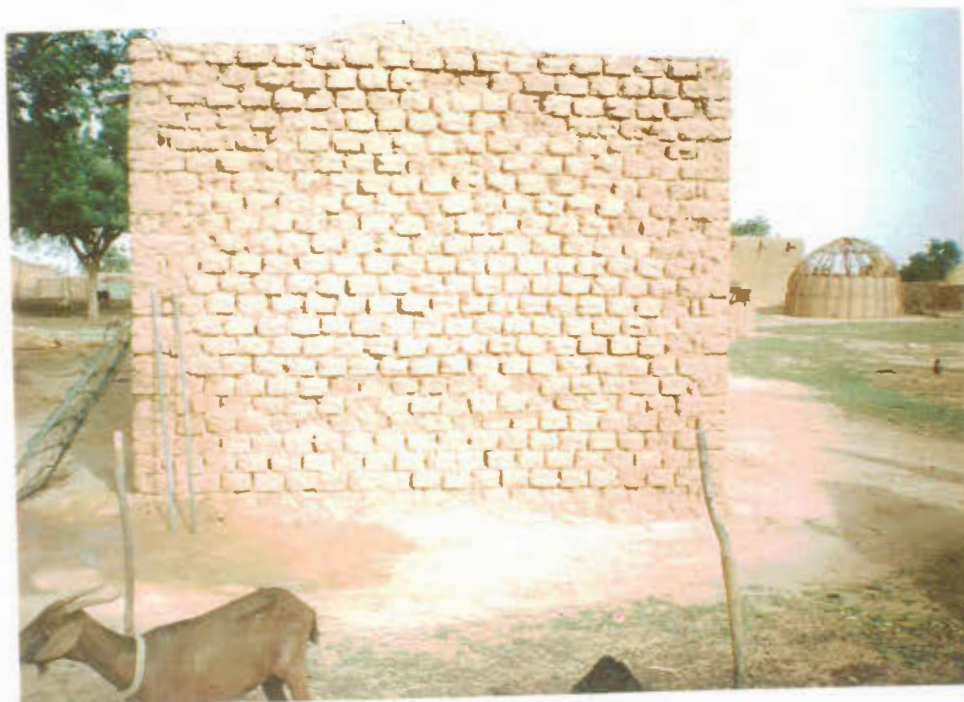
Photo No 6 : Maison CSB non entretenue
